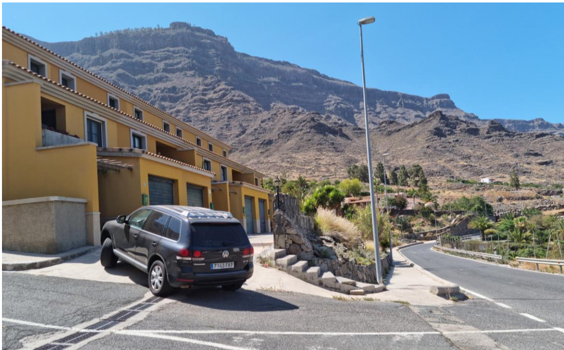
Pendiente acusada; Ausencia de paso para peatones; Asfalto en mal estado. Fuente: LPA Studio.
