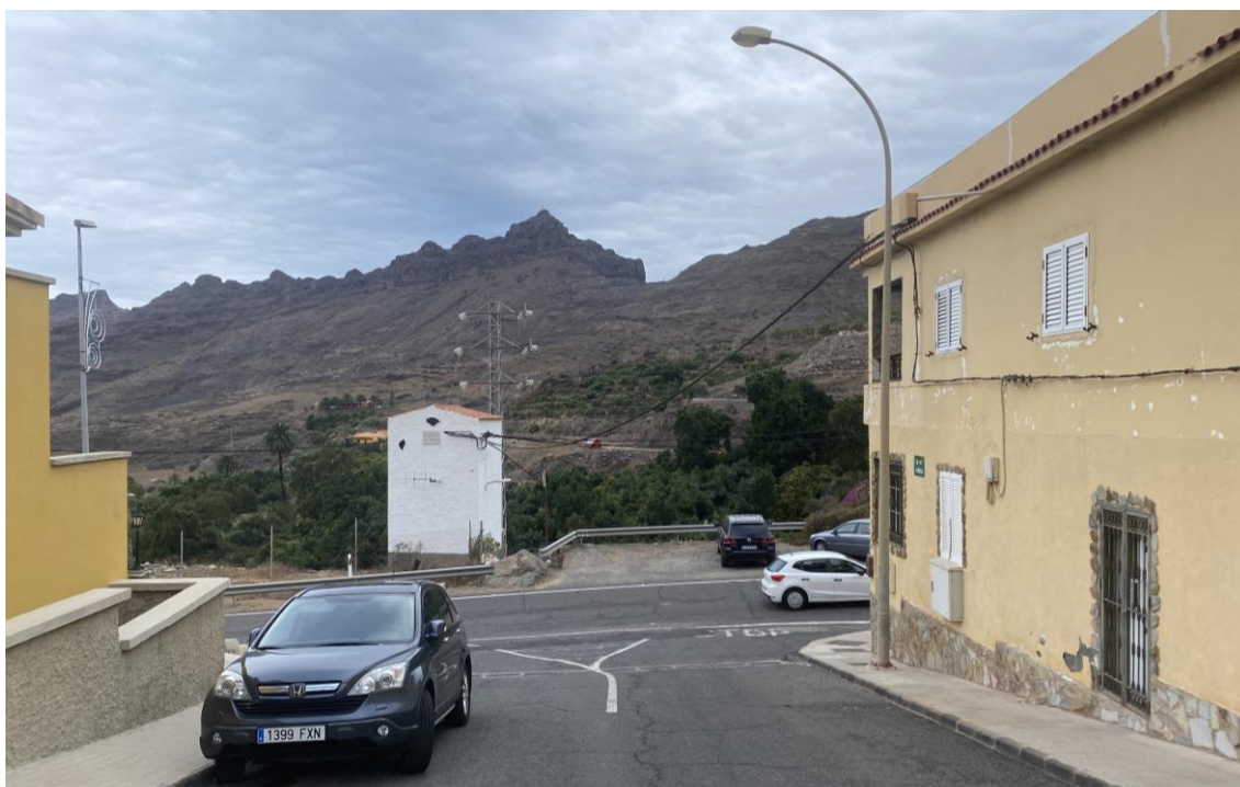
Estación transformadora del ámbito de ordenación junto a torre de alta tensión. Fuente: LPA Studio.
